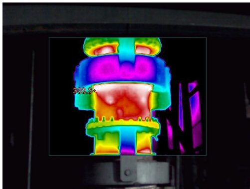
26号送風支管の最高温度は303℃で、正常である
