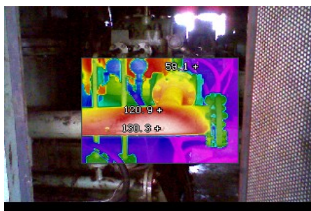
パイプラインの厚みの減り
